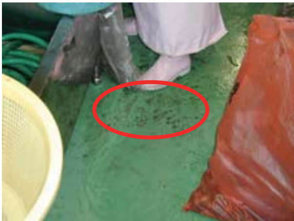
泥付き野菜で汚染された検収室の床
